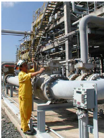
Cán bộ bảo trì của Nhà máy chế biến gas Dinh Cố đang kiểm tra hệ thống máy móc
