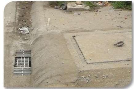
Miệng cống đã được cải tạo theo GPHI trên đường Nguyễn Ảnh Thủ, quận 12 cho thấy rác không còn trên miệng cống. Ảnh: Đồng Xuân Dũng.
