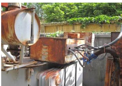
Sử dụng các thiết bị điện cũ và lạc hậu
