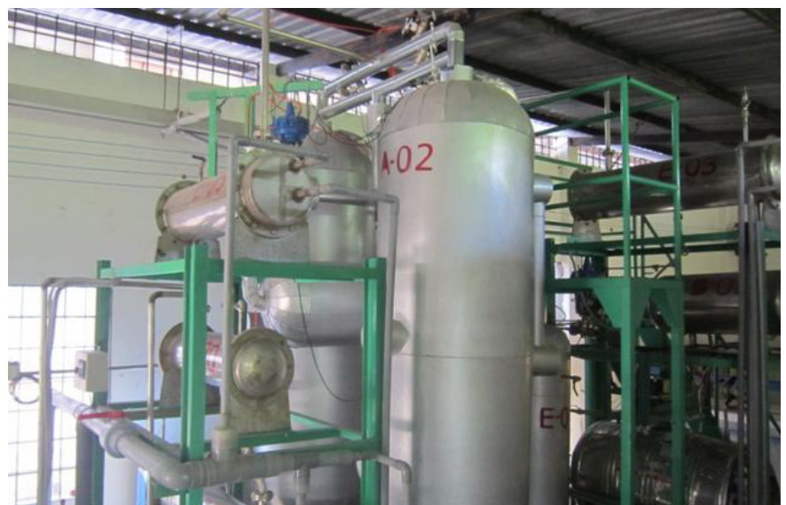
Hình 1: Hệ thống tinh luyện cồn tại RPTC
